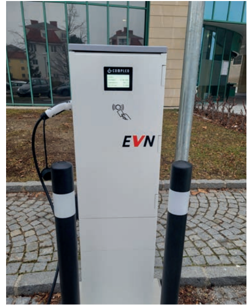
Foto: BH Baden Inbetriebnahme einer E-Ladestation (22kW).
